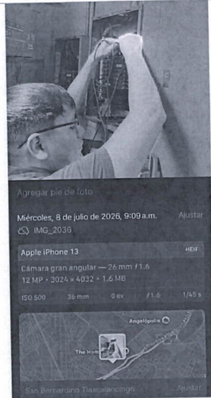
Revisión de pastillas y cableado de tablero secundario
